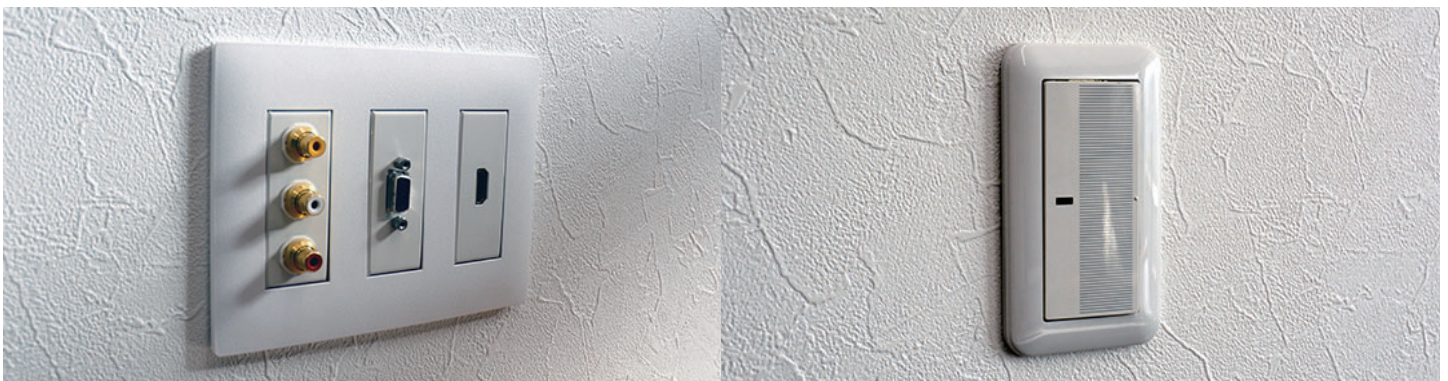
▲ 壁面に各種端子と電源スイッチを設置
