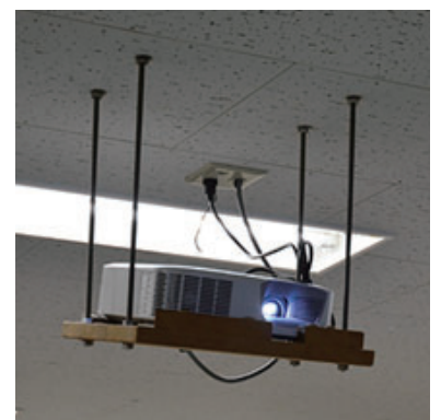
▲小型・軽量性を生かし、以前から使用している天吊り台に固定して設置
